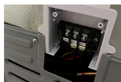
nouveau système de câblage
